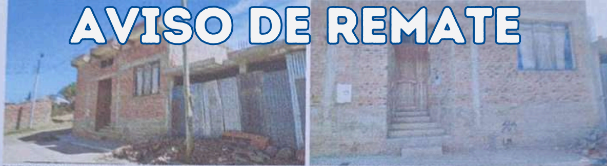
FOT. N° 3 Y N° 4. DETALLE CONSTRUCTIVO EXTERIOR Y ESTADO DEL INMUEBLE OBJETO DE LA LITIS. BLOQUE A.
